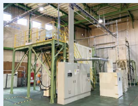
粉碎分離設備
