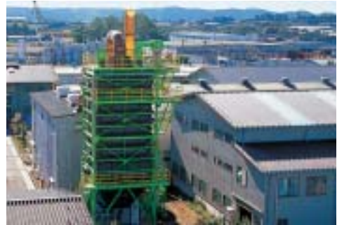
排ガス処理設備 ：ダイオキシンの発生を厳しく抑えた排ガス処理設備。厳しく強化される環境法規制に対応し、循環型社会の形成に貢献しています。
