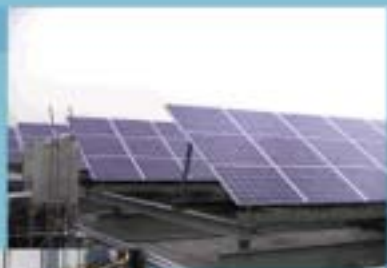
太陽光発電システム
