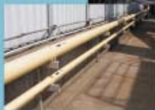
天然ガスを供給するパイプライン
