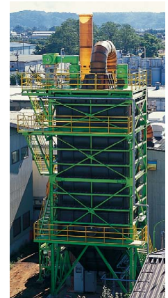
排ガス処理設備
