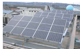
開発センター 太陽光発電システム
