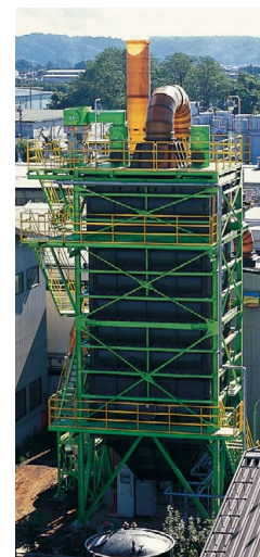
排ガス処理設備
