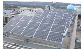
開発センター 太陽光発電システム
