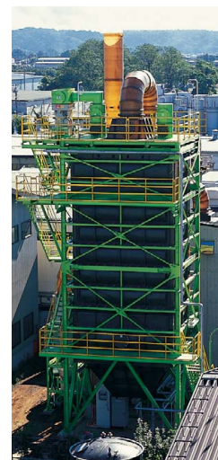
排ガス処理設備
