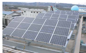
開発センター 太陽光発電システム
