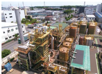
廃液濃縮・高温酸化処理設備 (MCRシステム)
