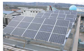
開発センター 太陽光発電システム
