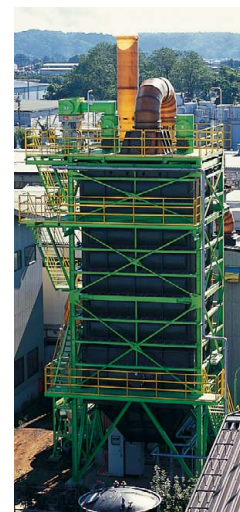
排ガス処理設備
