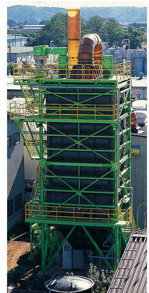
排ガス処理設備
