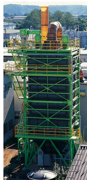
排ガス処理設備
