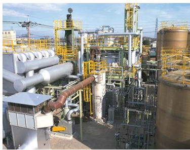
廃液濃縮・高温酸化処理設備 (MCRシステム)
