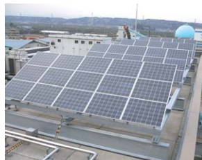
開発センター 太陽光発電システム
