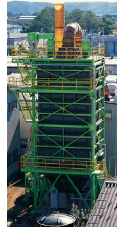
排ガス処理設備
